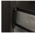
Figura 1b: Instalação em rack
